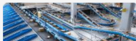
Centre de distribution
